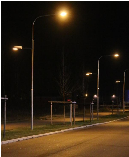
Figur 29: Stolpar med olika höjd för armaturerna över GC-väg respektive körbana. Bild: Joel Rosdahl.
